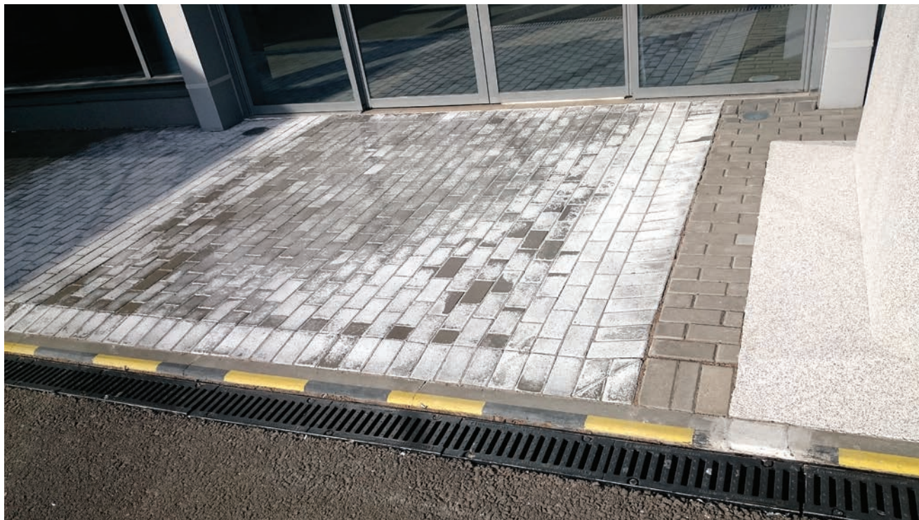
Рис. 6. Появление белых налетов на мощении из-за отсутствия отвода воды с бетонного несущего основания под плиткой.
